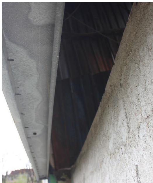
Figura 28. Exemplo de parede composta por uma parte metálica e outra em alvenaria, onde é visível a separação entre ambos.
